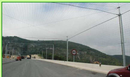
Photos 35: Dispositif de filet anti collision :
