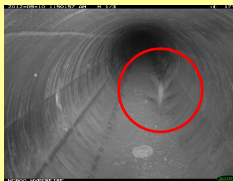
Photo 122 : Passage de Chiroptère dans une buse de 1200 mm de diamètre et 53 m de long, réalisée sous l'A10. Le suivi en cours montre plusieurs franchissements par les Chiroptères (Source : LPO France / Vinci Autoroutes/réseau ASF – 2012)
