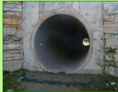
Photo 44 : buse de diamètre 2.20 m
