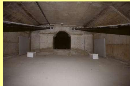
Photo 100 : Voussoir d'un pont sur le Cher aménagé avec des parpaings (Source : L. Arthur – Muséum Bourges)
