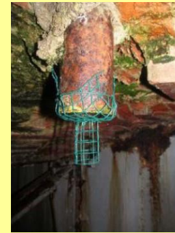
Photo 16 : Exemple de dispositif anti-retour utilisé dans le cadre de la réfection d'un ouvrage d'art (Source CPEPESC Franche-Comté)
