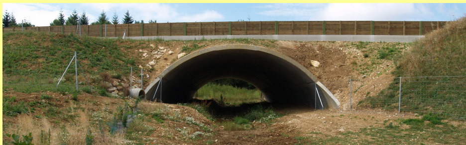
Photo 47 : Ouvrage inférieur de l'autoroute A88 équipé d'un écran d'occultation (source : Groupe mammologique Normand)
