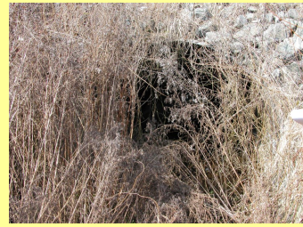
Photo 50 : Entrée d'une buse obstruée par la végétation (Source : L. Arthur – Muséum Bourges)
