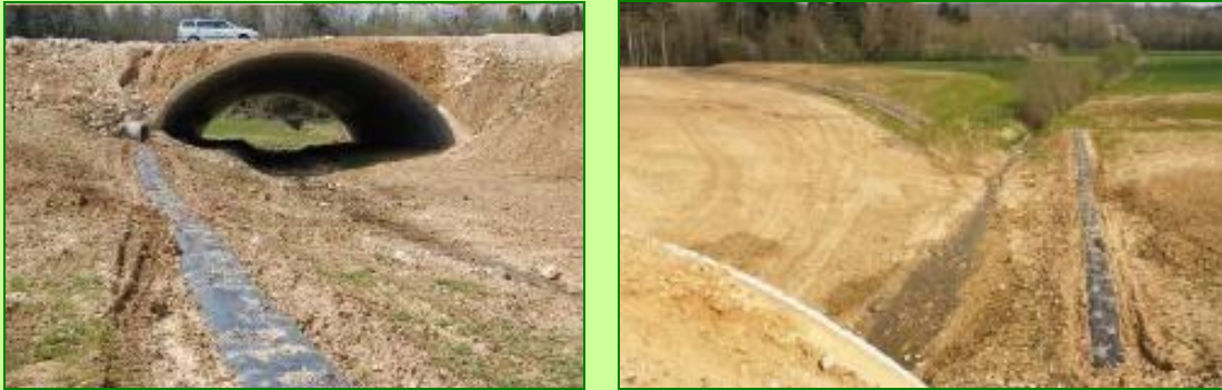
Photos 21 et 22 : Ouvrage inférieur suivi en phase chantier - (Source : Groupe Mammalogique Normand)
