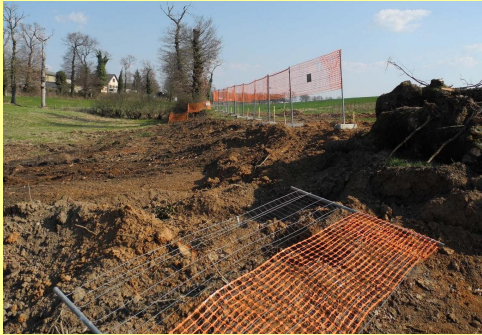
Photo 70 : Dispositif de guidage provisoire en phase chantier sur la RN 88 dans le Tarn et l'Aveyron (région Midi-Pyrénées). (Source : Sophie Bareille - CREN MP)
