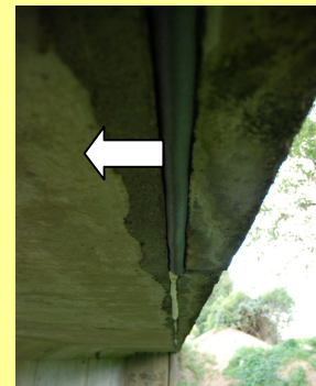
Photo 18 : Cavité bouchée à l'aide de gaine d'isolation de tuyau de chauffage (Source : S. Bareille)
