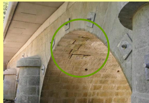
Photo 135 : Interstices non rejointés lors des opérations d'entretien de l'ouvrage (Source CPEPESC Franche-Comté)
